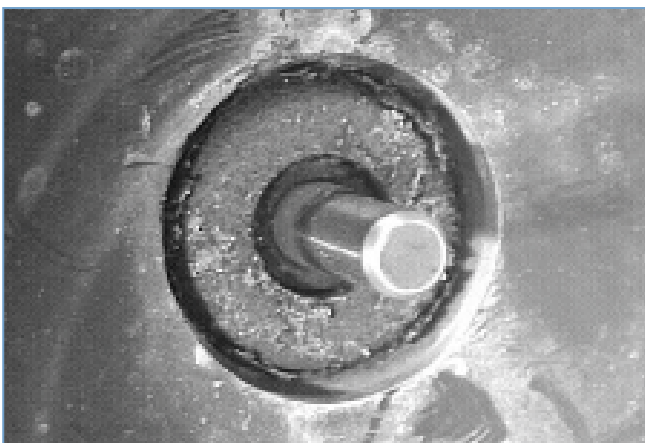
Abb. 1 Lager sind korrodiert
